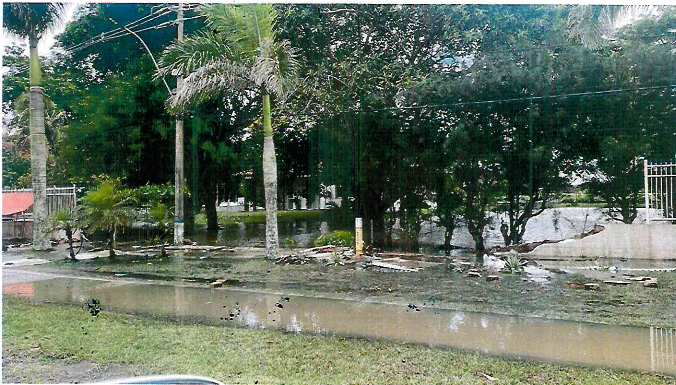
Muro da Base Aeronaval de São Pedro da Aldeia caiu com a força da água. — Foto: Defesa Civil de São Pedro da Aldeia
