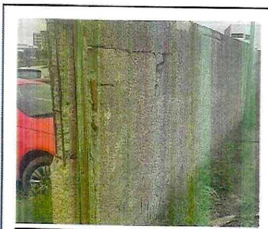
Muro da SEMED afetado pela chuva.
