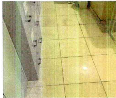
Água acumulada Manoel Moraes.
