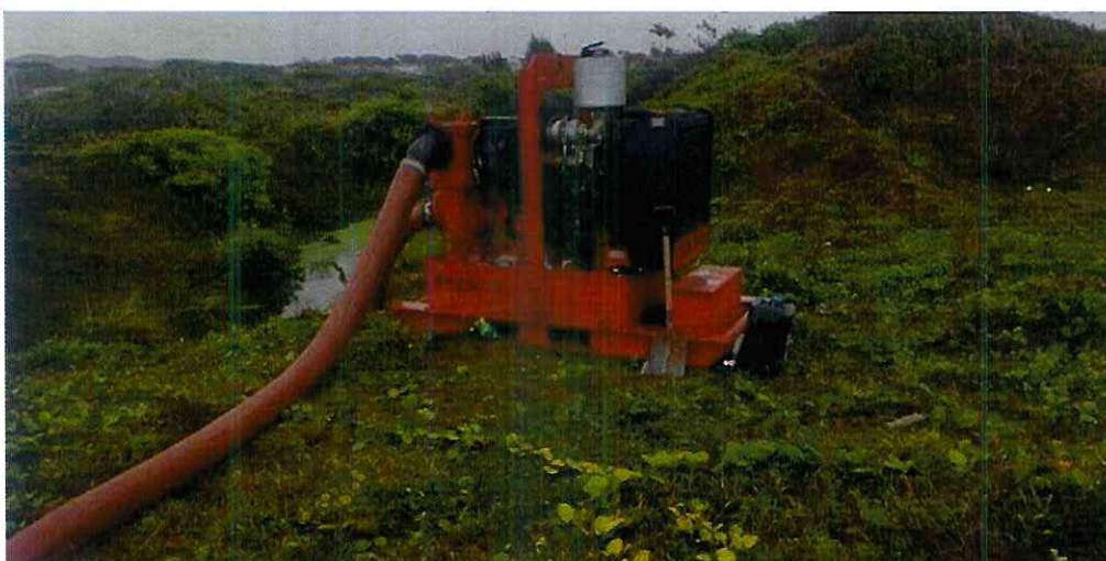
Bombas de alta vazão estão sendo utilizadas em Búzios | Foto: Divulgação/Prefeitura de Búzios
