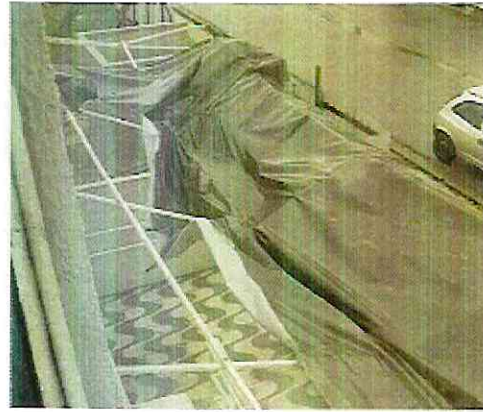
Toldo da SEMED danificado.
